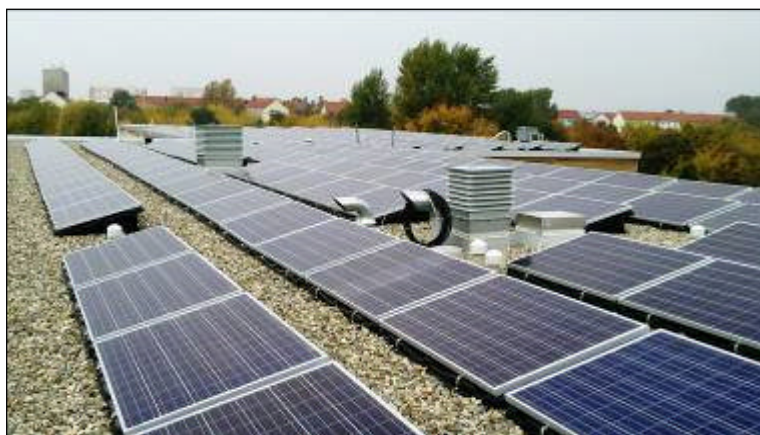
Bild 8 Photovoltaik und Fortluftkanäle
