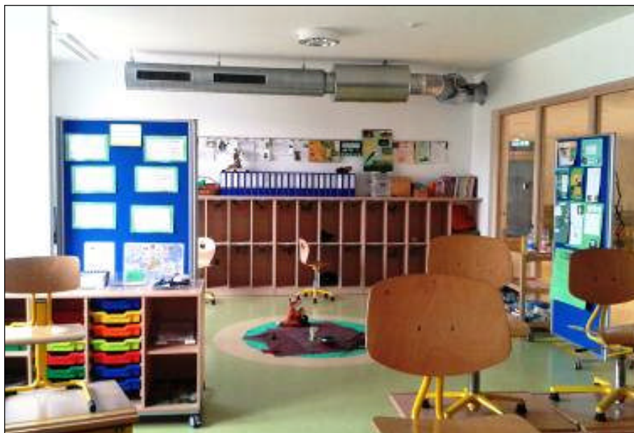
Bild 5 Großzügige Bewegungsfläche und Lüftungsanlage im Klassenraum
