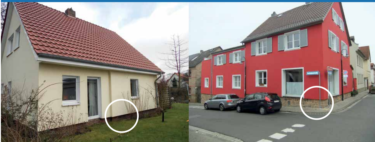
Abb. 16 Sanierungstest: Wärmebrücke an Fassade und Sockel
