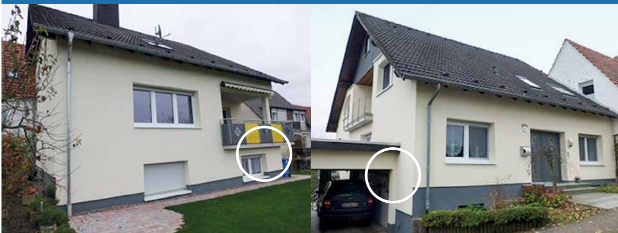
Abb. 17 Sanierungstest: Wärmebrücke am Balkon und beim Gebäudeanschluss
