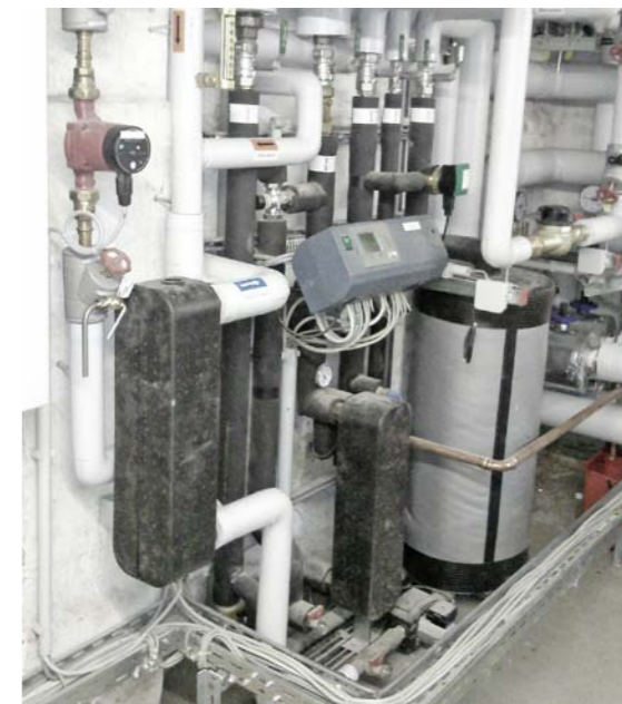
5 Die Solarthermieregulierung ist häufig nicht nur sehr komplex, sondern mangels Dokumentation für viele Betreiber ein Buch mit sieben Siegeln.
