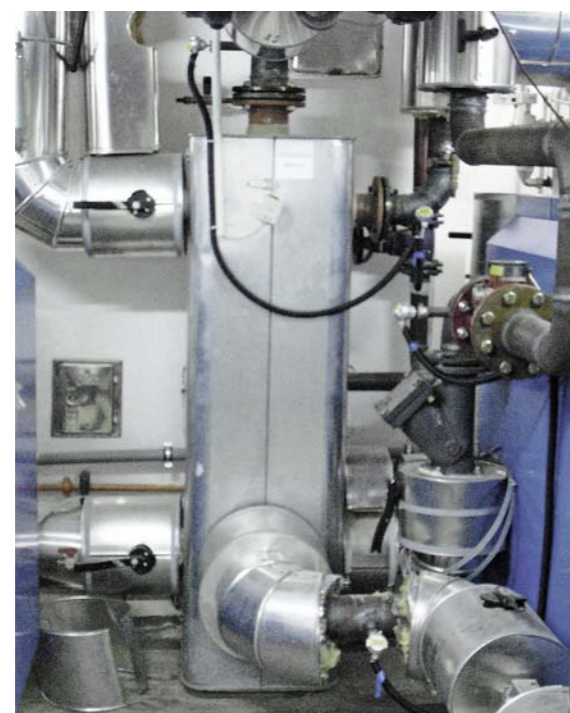
4 Effizienter als hydraulische Weichen sind in vielen Fällen ein knapp dimensionierter und gut gedämmt Kesselpuffer mit intelligenten Regelstrategien.
