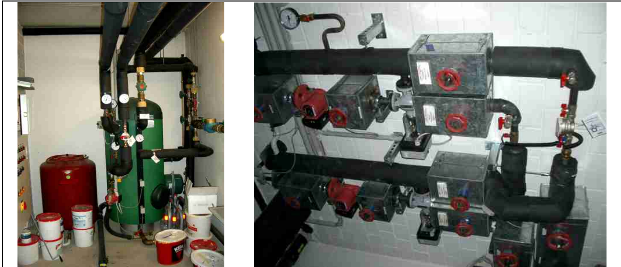
Abbildung 2 (N40, N41) Fotos von zwei aufgenommenen Heizungskellern
