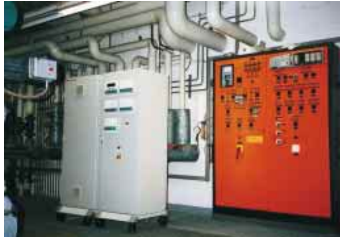
Energiemanagementsystem – eingebunden in eine vorhandene Schaltschrankanlage.
