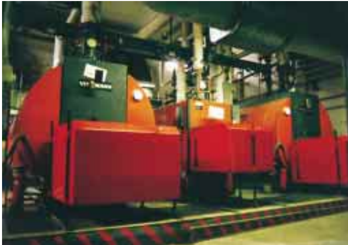
Heizkesselanlage mit 3 Wärmeerzeugern unterschiedlicher Leistung.
